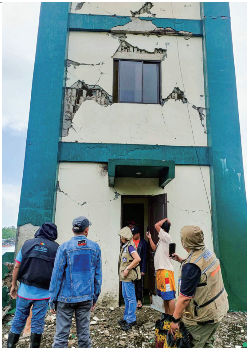
2023年12月3日，菲律宾南苏里高省发生地震后，一座建筑严重受损。（图/Newscom）
